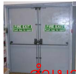
รูปที่ 11.2 ประตูหนีไฟ
