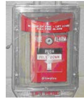
รูปที่ 7.12 อุปกรณ์แจ้งเหตุเพลิงไหม้
